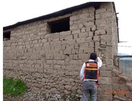
Figura 13. Viviendas o infraestructura construidas sin tomar en cuenta las normas de construcción; es decir, sin contar con planos, buenos materiales o tomar en cuenta el tipo de suelo en el cual se quiere construir.
