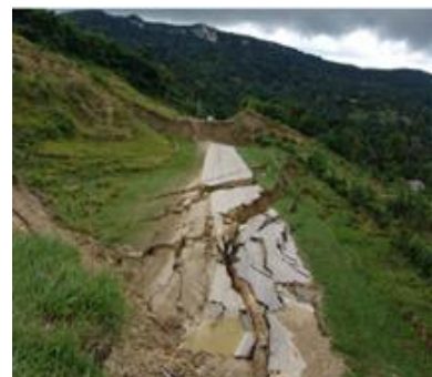
Figura 10. Grietas o rajaduras en la superficie del terreno
