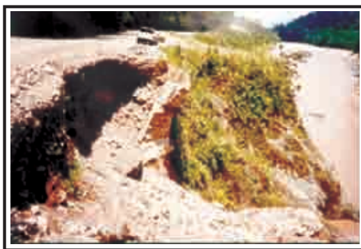
Carretera afectada por erosión.
