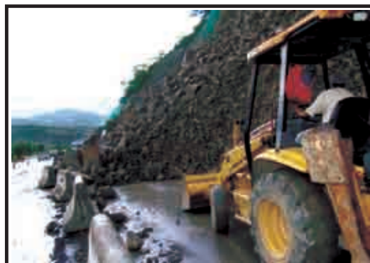
Carretera Central bloqueada por deslizamiento de rocas.
