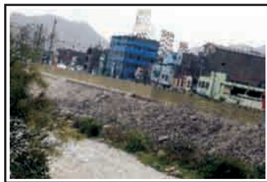
Erosión causada por el río Rímac.
