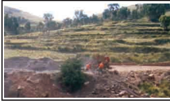
Derrumbe en zona andina.
