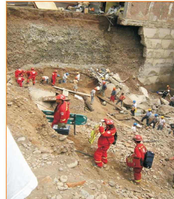
COLAPSO DE PARED- DIST. LA VICTORIA – DPTO. LIMA - 12-12-2007
