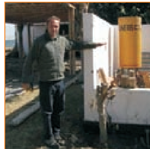
VIVIENDAS AFECTADAS POR EL TSUNAMI EN PARACAS
