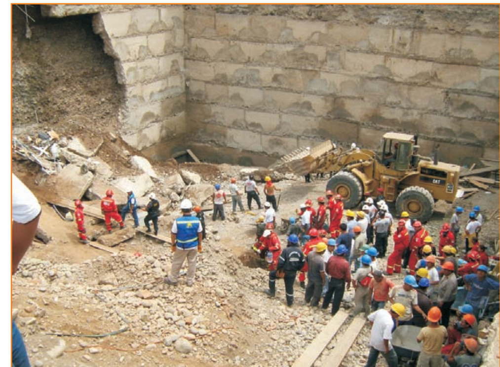
DERRUMBE DE PARED- DIST. LA VICTORIA – DPTO. LIMA - 12-12-2007
