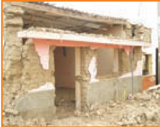
Viviendas destruidas en Chincha
