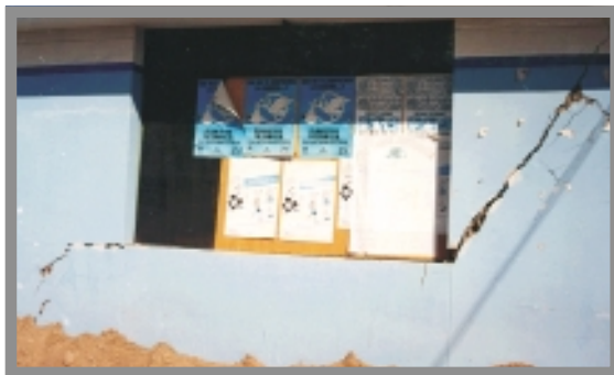
FIGURA 1 DAÑOS EN ESTABLECIMIENTO DE SALUD DEL PRIMER NIVEL DE ATENCIÓN. MOQUEGUA: TERREMOTO DEL SUR DEL PERÚ. 2001
