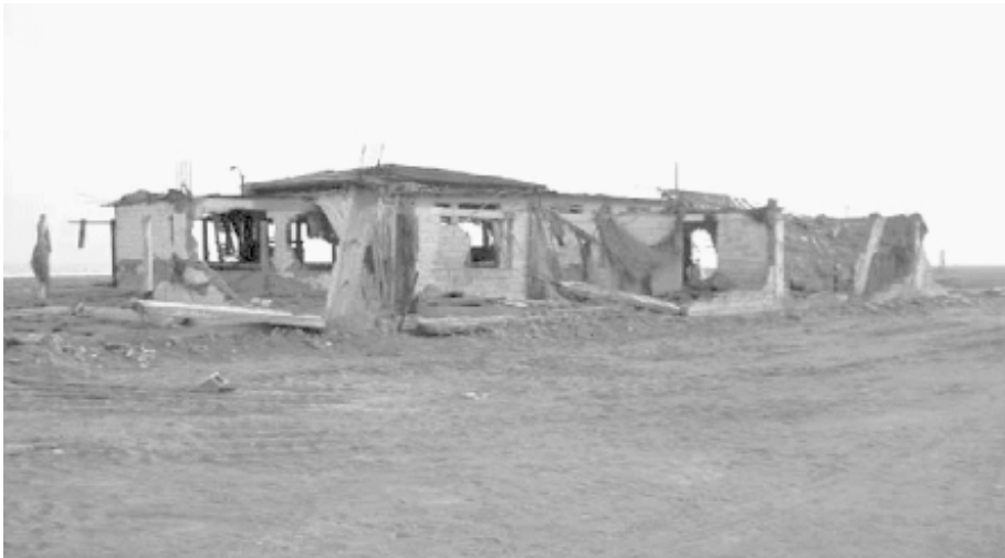
Figura # 2 Efectos del maremoto en una vivienda construida en Camaná con estructura sismorresistente
