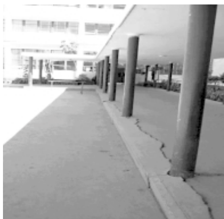
Figura # 6 Hospital Hipólito Unanue de Tacna. Grietas en la base de columnas
