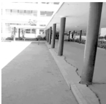
Figura # 6 Hospital Hipólito Unanue de Tacna. Grietas en la base de columnas
