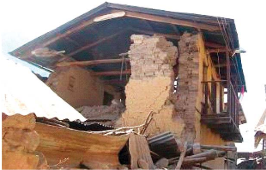
Gráfico N° 36. Vivienda Colapsada en Yauyos
