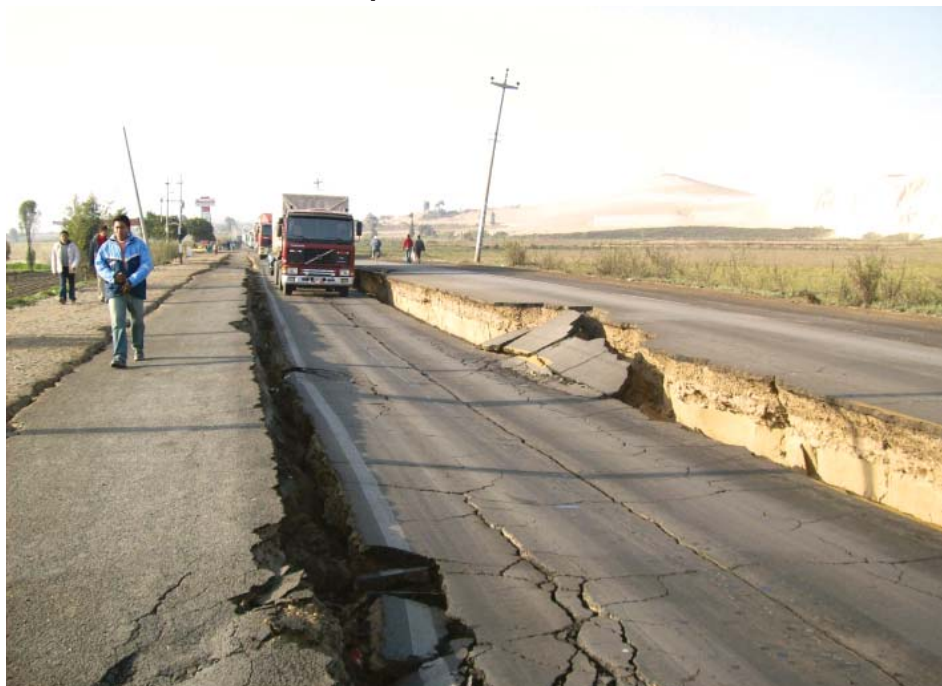
Gráfico N° 8. Daños en superficie de la Carretera Panamericana Sur
