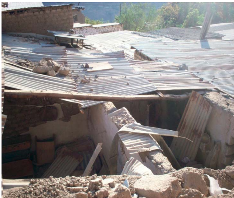
Gráfico N° 35. Vivienda colapsada en Huancavelica
