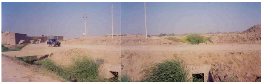
Zona de Probable Licuación de Arenas: Salida a Lambayeque
